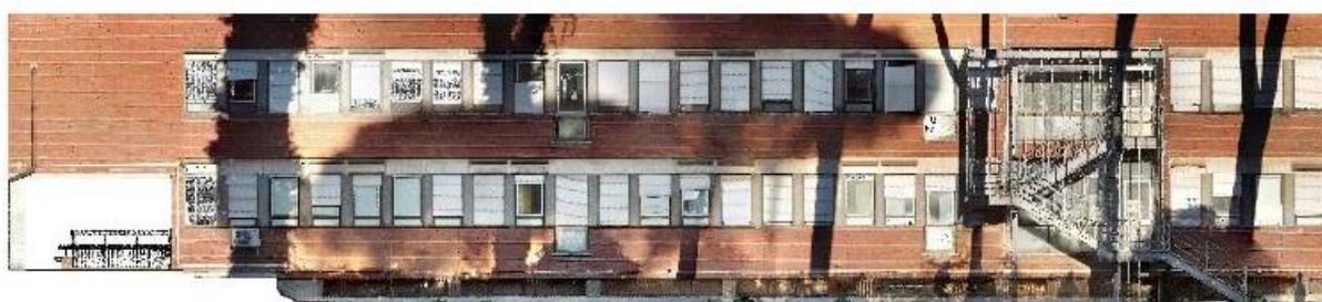
Stalcio del fotopiano su prospetto Sud-Ovest (PRE-INTERVENTO)
