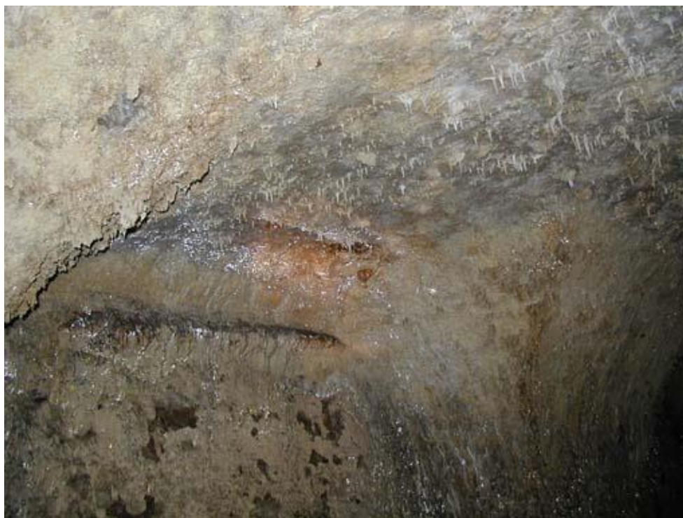
Particolare effluorescenze calcaree
