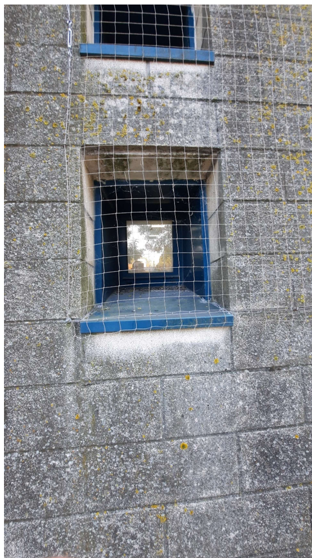
FOTO 2 particolare luci in parete
