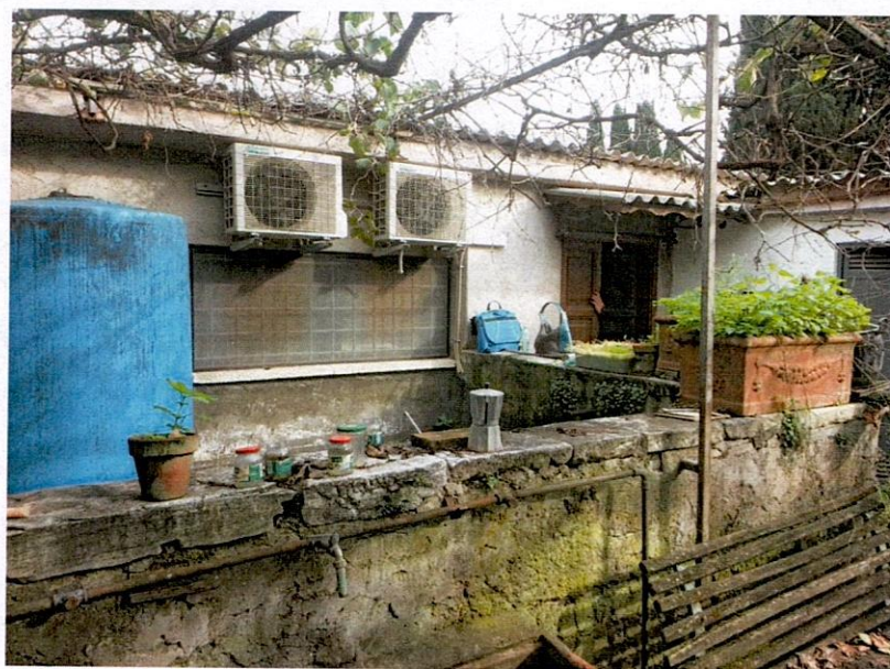
8. Viste degli edifici fatiscenti da demolire
