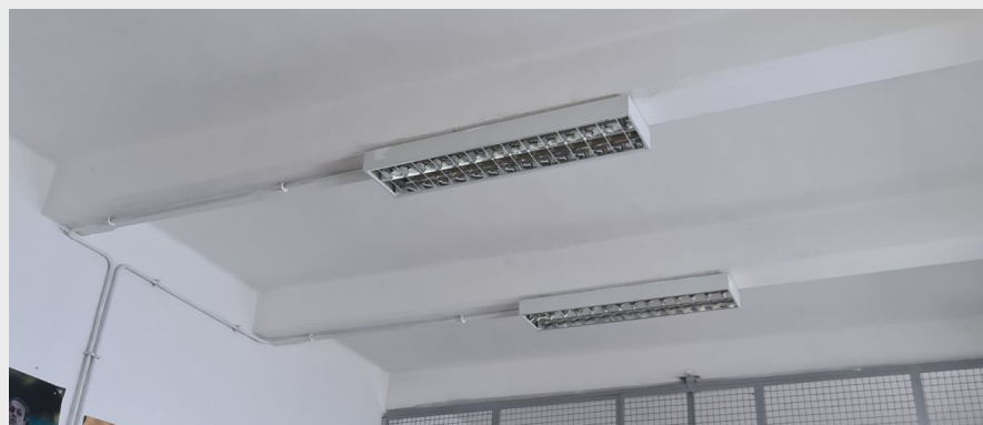
01 - Spazi a servizio dell'impianto
