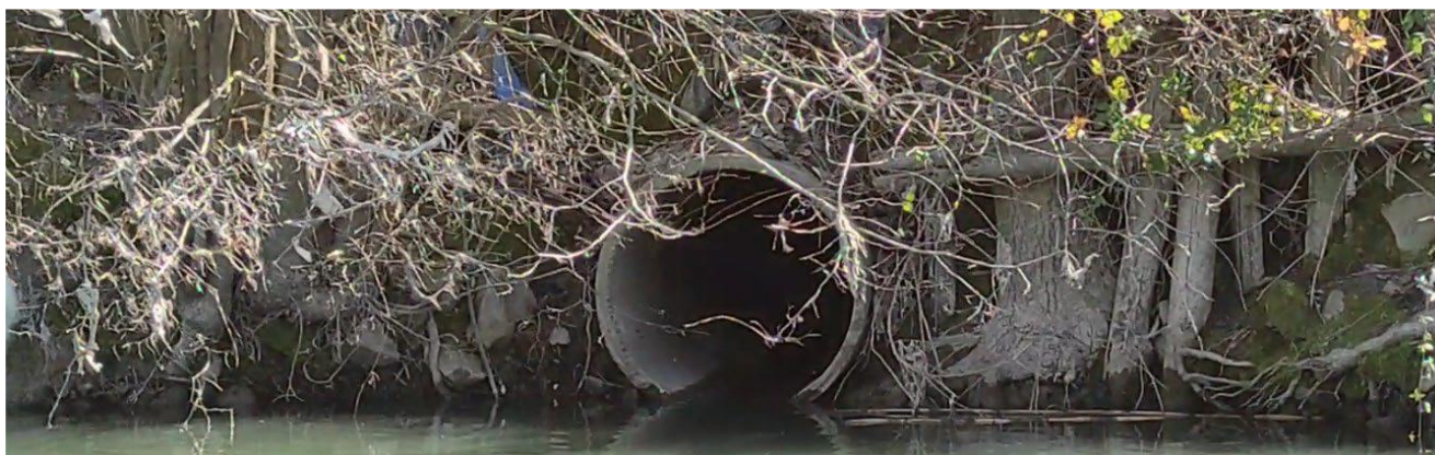
In alto, le opere a scogliera divelte a valle e a monte della rampa; in basso la tubazione di scarico
