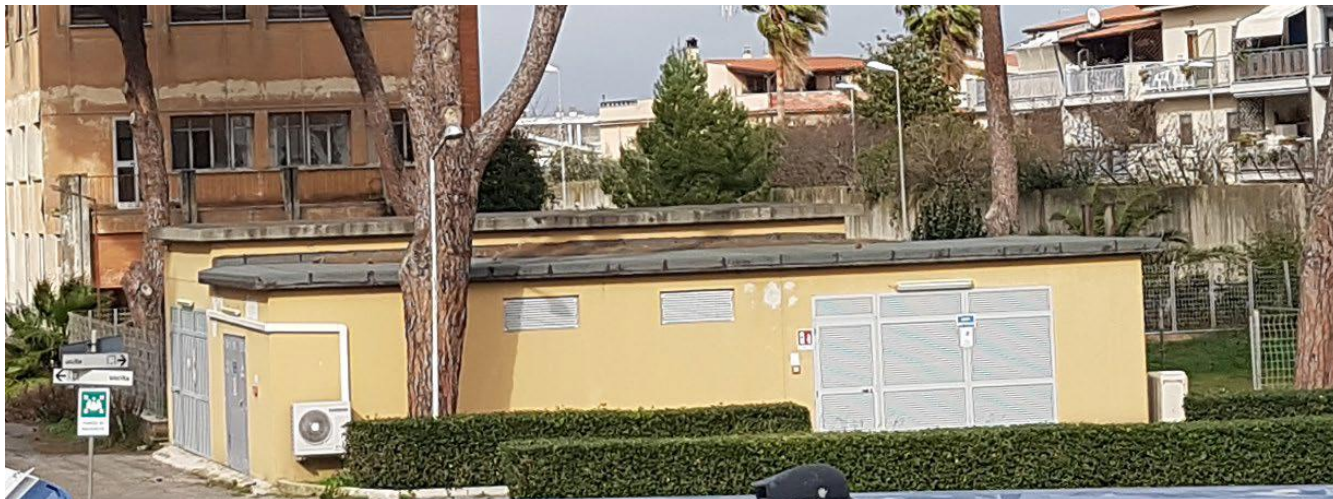
Immagine 8 - Cabina elettrica
